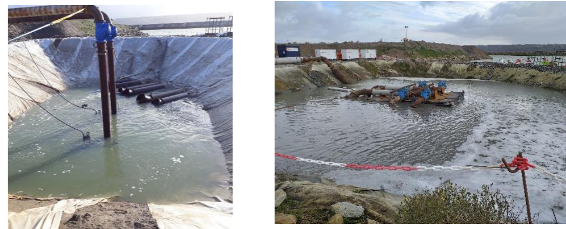
Figure 31 : Exemple de bassin de décantation des rejets
