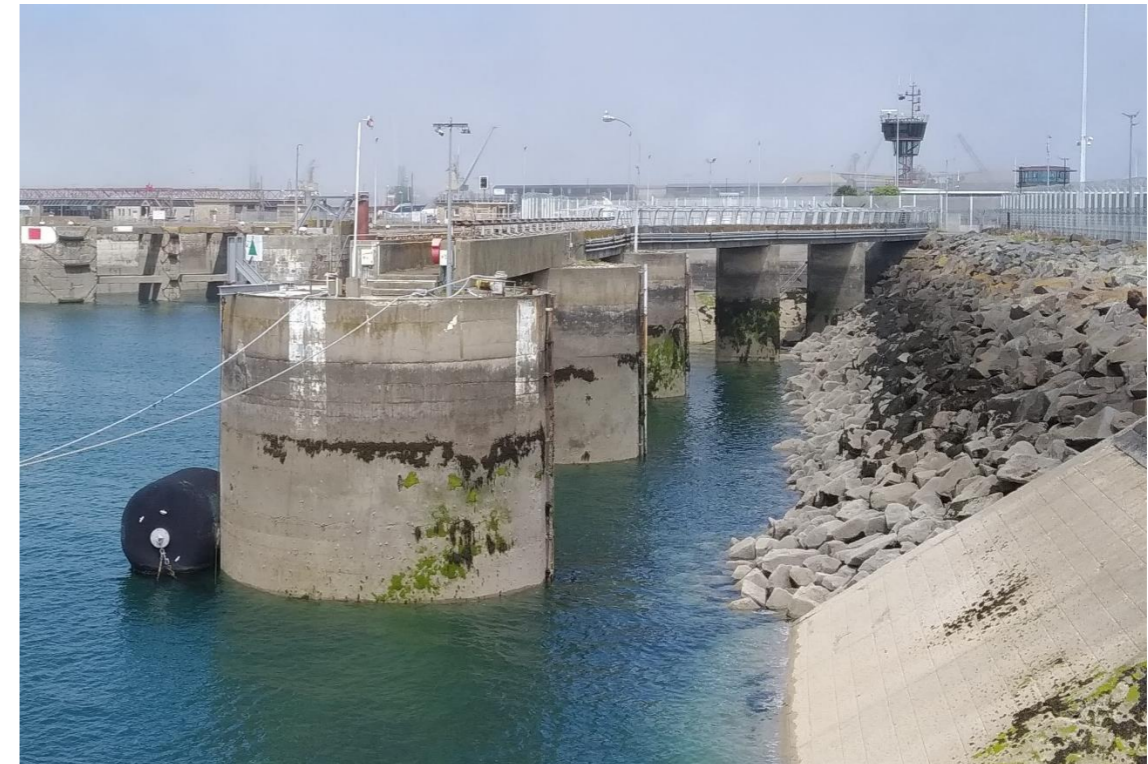
Figure 43 : Etat actuel des caissons DACs du poste 1
